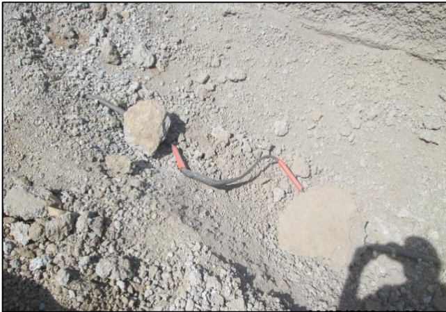
ATT Spliced Phone Conductors
