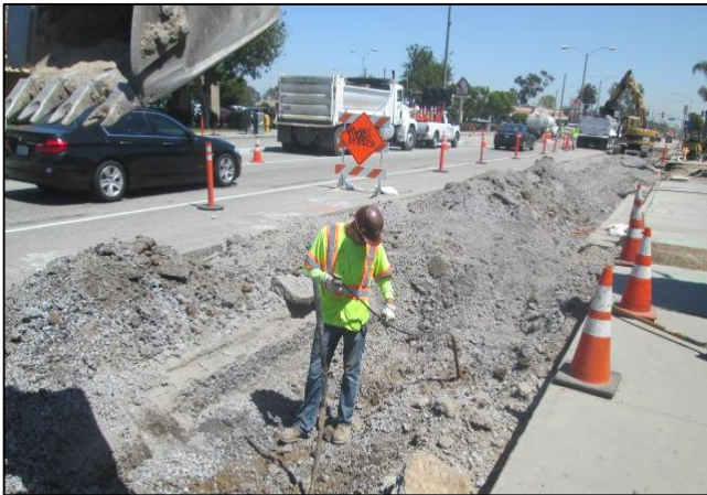
Backhoe Ripped Out ATT Line
